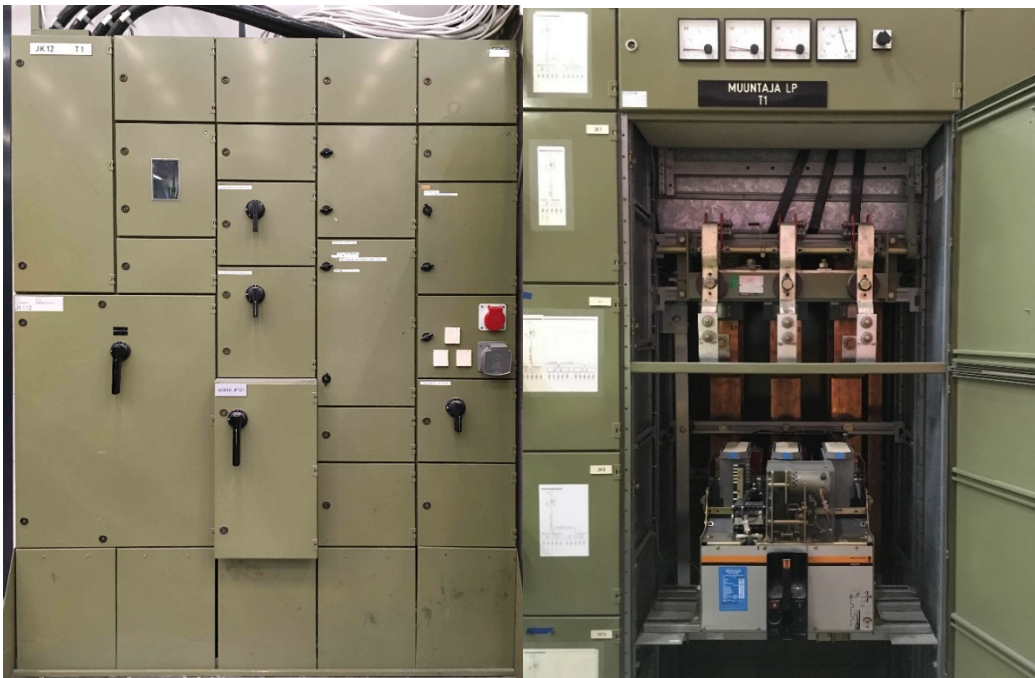
Kuva 4.5. Vasemmalla Vaasan kytkintehtaan jakelukeskus ja oikealla pääkeskus, jonka olemassa oleva katkaisija korvataan uudella Emax 2 -katkaisijalla.
