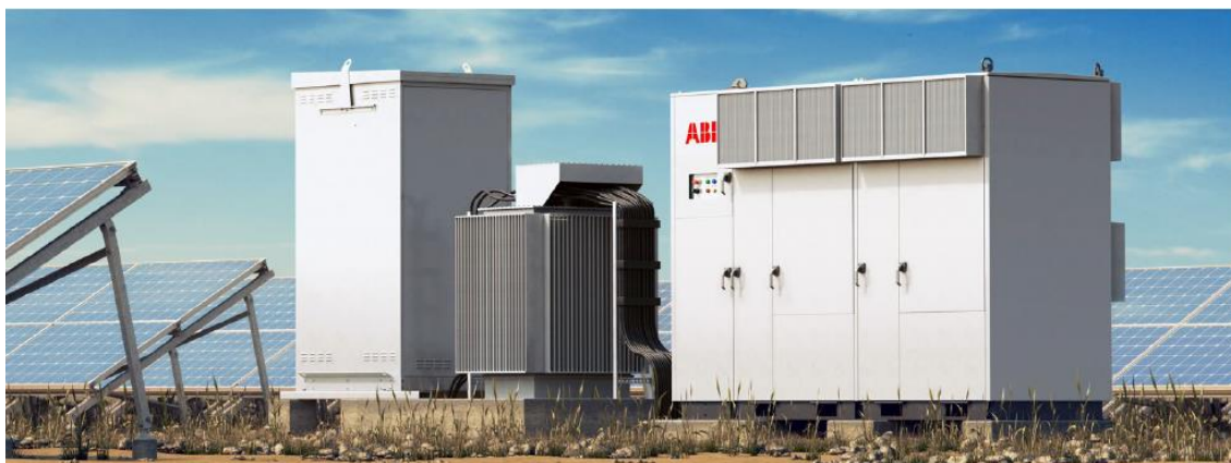
Kuva 7. Vasemmalta oikealle: kytkinlaitteisto, jakelumuuntaja ja keskusinvertteri (ABB 2017)
