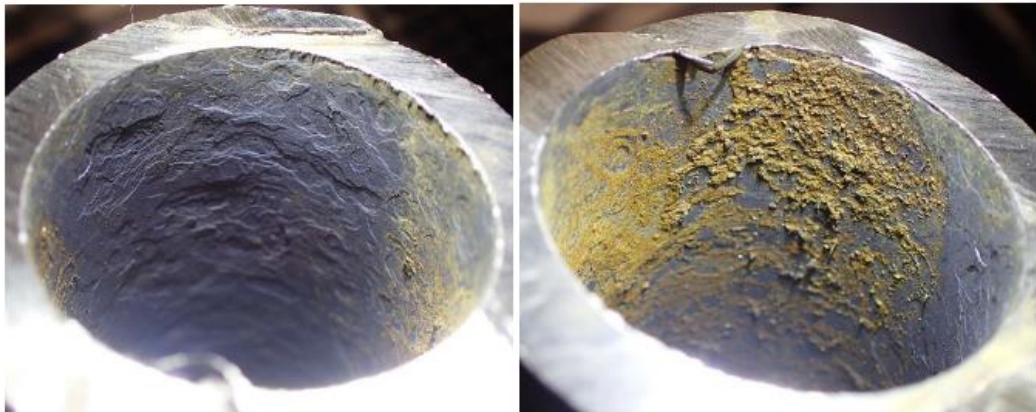
Kuva 9. Näyteputken sisäpinnan oksidi- ja ruostekerrostumat. (Tuiremo 2019, 3)
