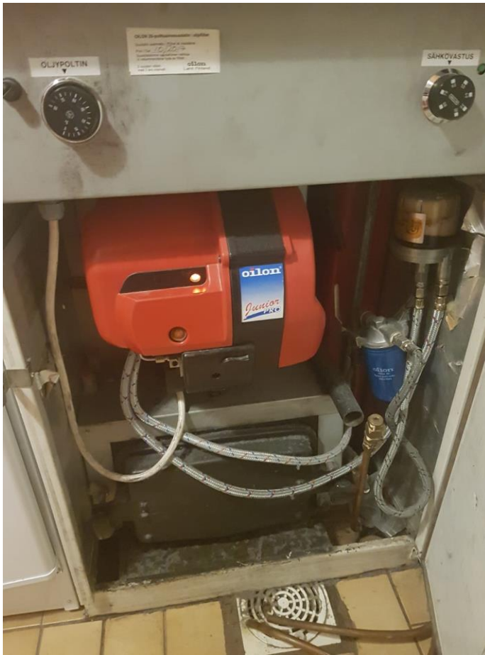
Kuva 2. Kohteen öljypoltin öljykattilassa
