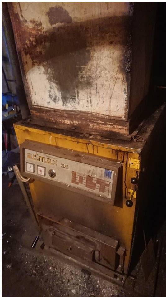
Kuva 1. Arimax 35-merkinen kattila ja polttoaineensyöttötorvi.
