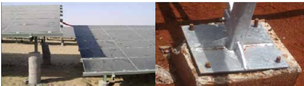
Kuva 13. Aurinkopaneelikentän puutteellisesti suunniteltu asennusmekaniikka ja perustukset (IFC, 2015).
