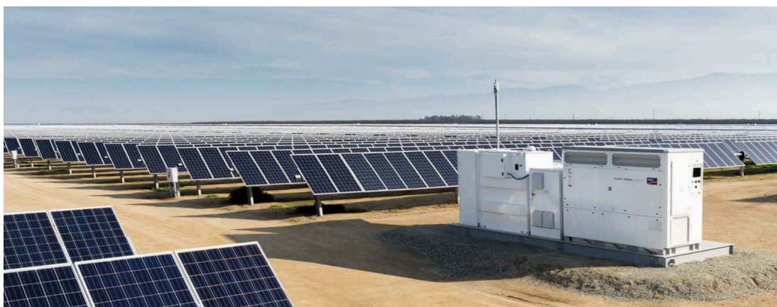
Kuva 11. Aurinkosähkövoimalan keskitetty vaihtosuuntaaja sijoitettuna aurinkovoimalan paneeliketjien läheisyyteen. (SMA, 2019)
