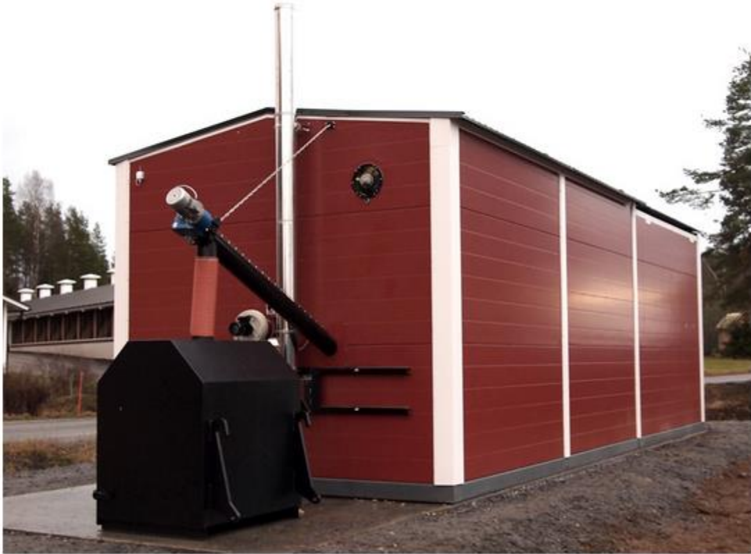
Kuva 6. Hakelämpökontti, jonka päädyssä on tuhkanpoisto ja savupiippu
