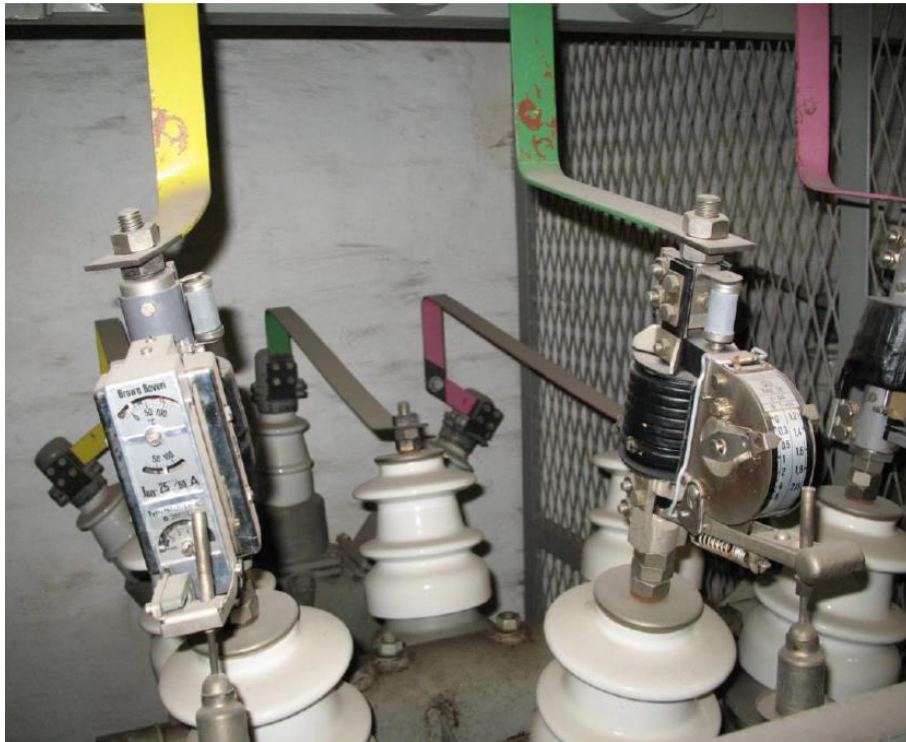
Kuva 6.4. Ensiörelleillä toteutettu suojausjärjestely (Lainattu lähteestä: Lasila 2020).
