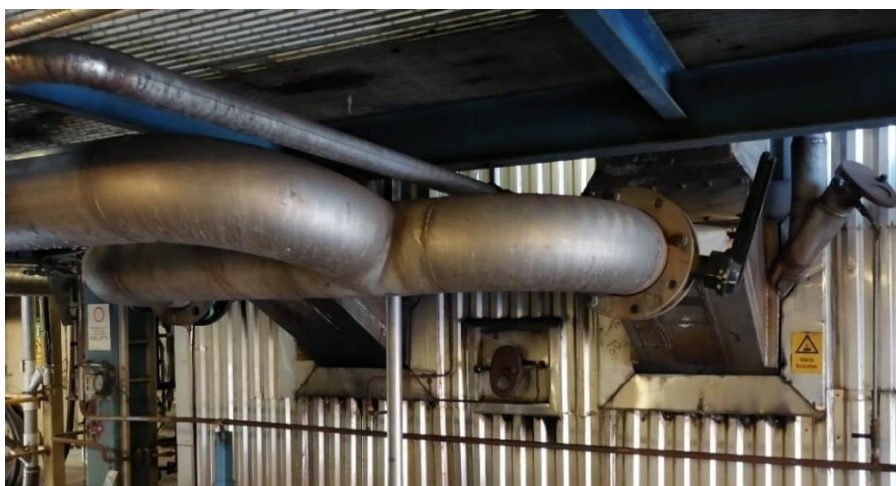
Kuva 12. Polttoaineen syöttötorvet ja heittoilmaliitäntä
