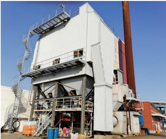
Kuva 13. Sähkösuodatin, savukaasupuhallin ja savupiippu
