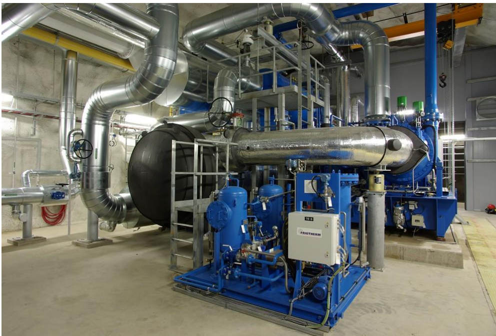
Kuva 8. Friothersin Unitop 50FY lämpöpumppu Helenin Katri Valan voimalaitoksella. (Friothers 2021.)
