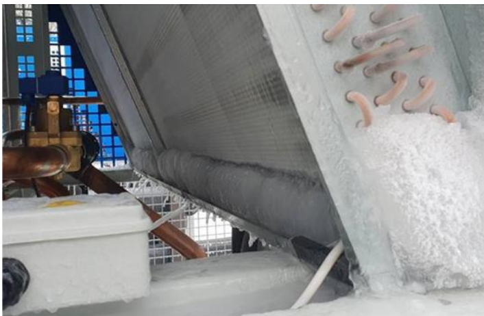
Kuva 22 Lamellipatterien alaosan jäätyminen.
