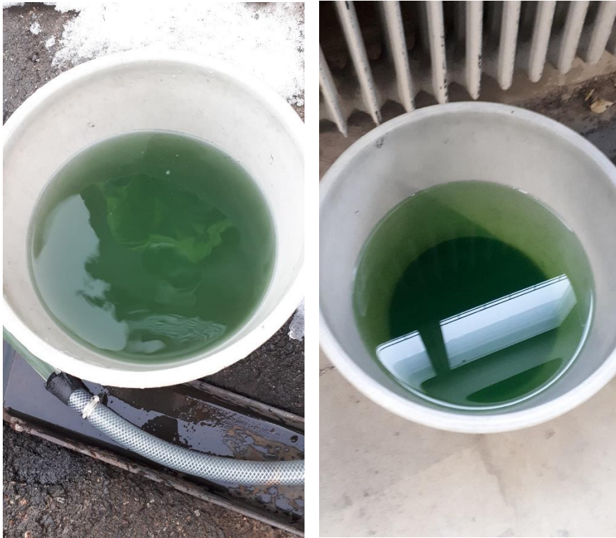
Kuva 24. Aluelämpöverkon vesinäyte. Vasemmalla kuva näytteestä näytteenottohetkellä ja oikealla seisotettu näyte, jossa sakka on vajonnut pohjalle.
