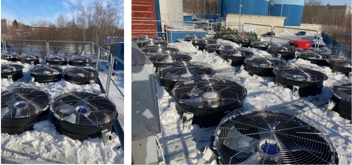
Kuva 18. Lämmönkeräimien päälle asennetut puhaltimet
