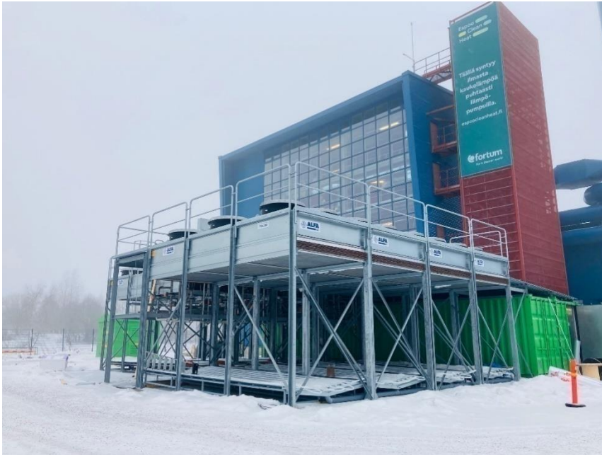
Kuva 16. Vermon ilmalämpöpumpun lämmönkeräimet ja lämpöpumppukontti
