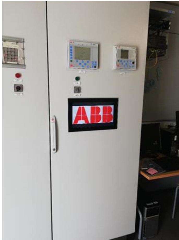
Kuva 7.6 Sähköasemakohteeseen asennettu paikallinen kunnossapitojärjestelmän server-laite
