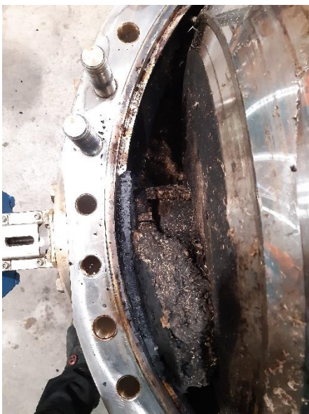
Kuva 11. Puuhakemassa on täyttänyt venttiilin välitilan.
