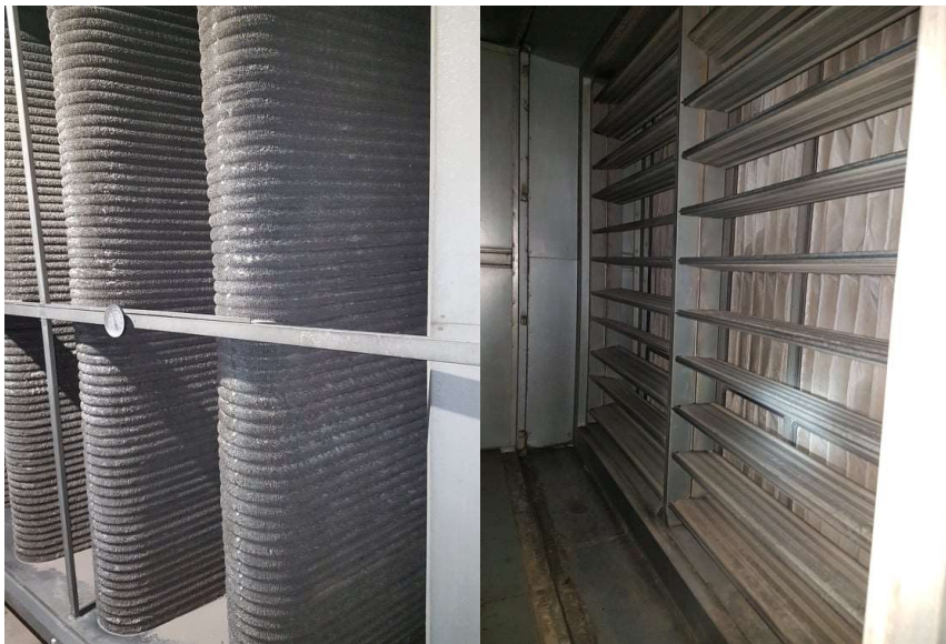
Kuva 17 Yksi tulopuolen lämmönvaihdinpattereista ja suodattimista
