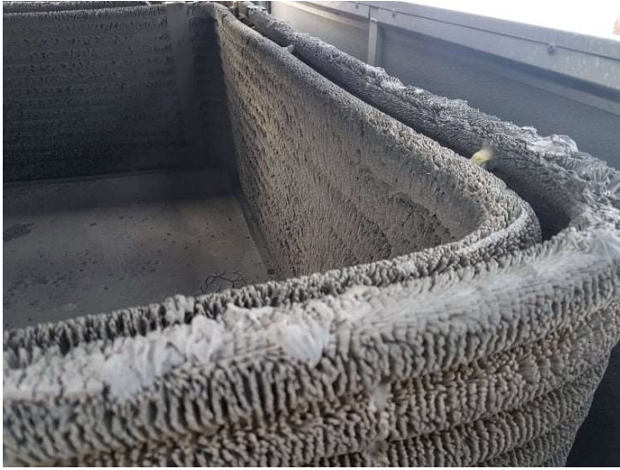
Kuva 20 VAK 02 ilmanvaihdon poistolämmönvaihdinpatterin pinta
