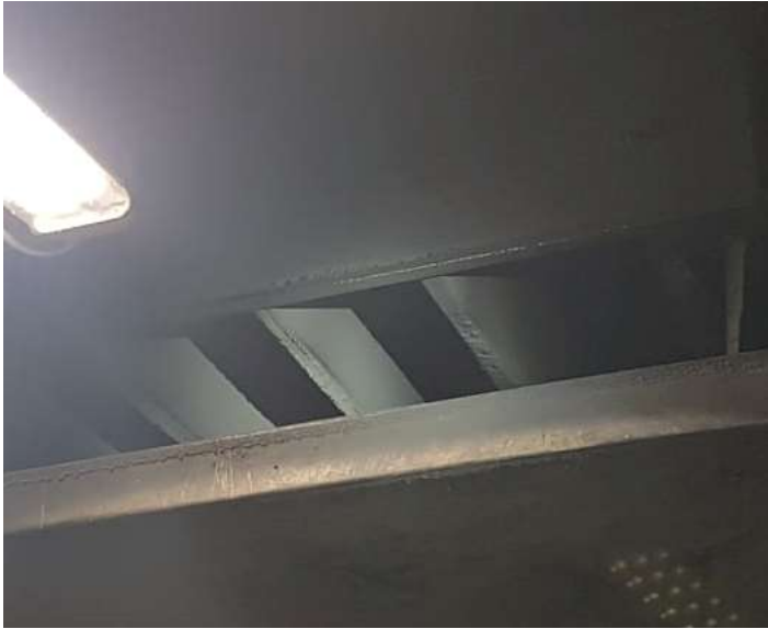
Kuva 22 Pinnoitustehtaan puristimen yläpuolella sijaitseva kärynpoisto
