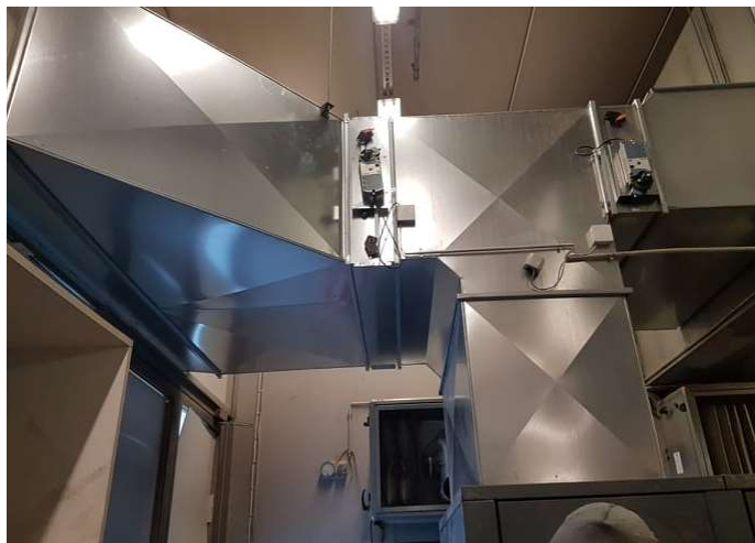
Kuva 27 VAK 10 Kompressorihuoneen ilmanvaihdon poistoputki
