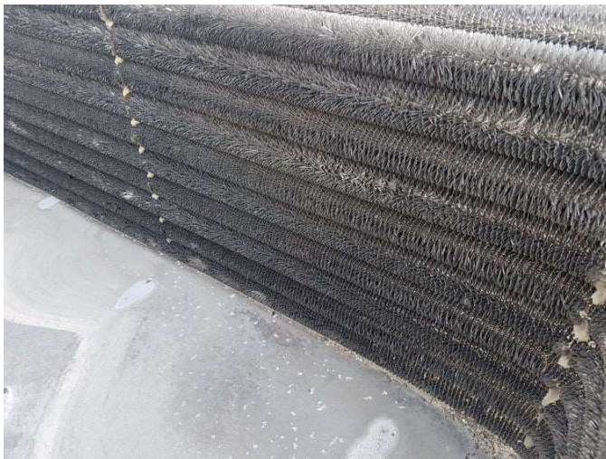
Kuva 24 VAK 10 poistolämmönvaihdinpatterin pinta
