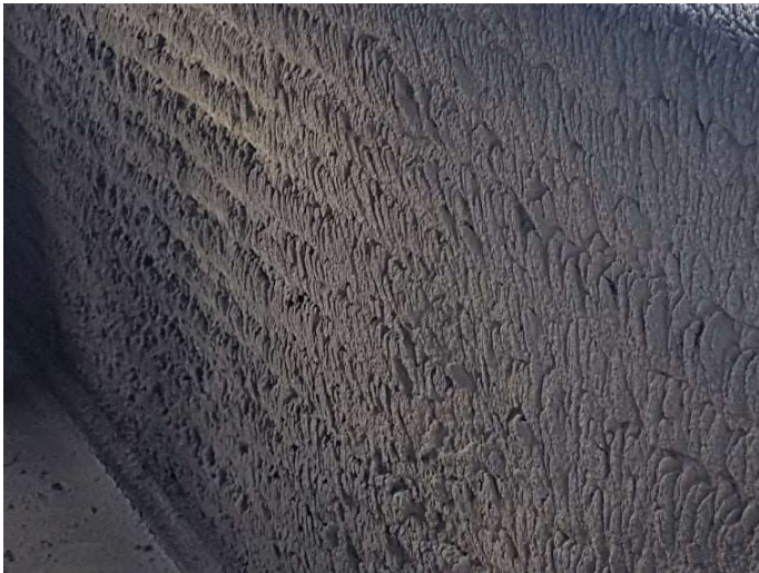
Kuva 21 VAK 02 ilmanvaihdon poistolämmönvaihdinpatterin pinta
