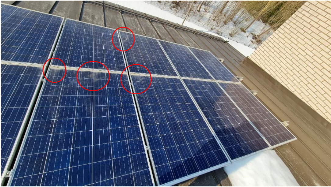
Kuva 21 Tytyrin vesilaitoksen aurinkopaneelien 74–81 pinnalla hiekkaa
