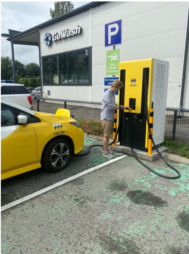
Kuva 3. RFID-tunnisteella tunnistautuminen latauslaitteelle.
