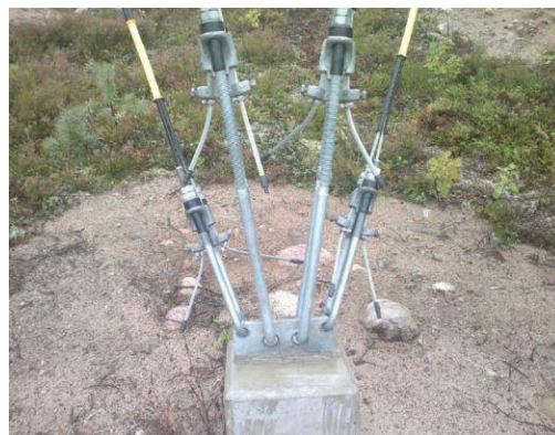
Kuva 7.5. Eristetyt harusten kiilakiristimet. (Fingrid Oyj, 2020).
