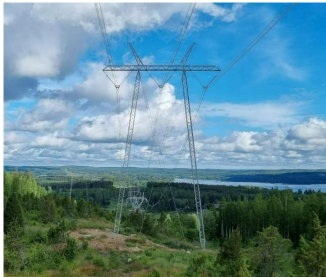
Kuva 2.4. 400 kV 1H-kannatuspylväs. (Sami Liikanen, 2022).
