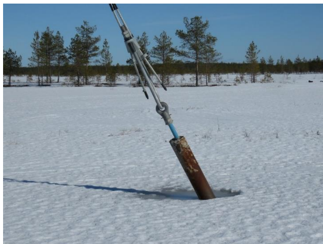
Kuva 3.9. 400 kV harustetun kannatuspylvään harusankkuri. (Risto Uusitalo, 2017).
