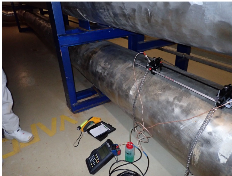
Kuva 21. TF13-piirin ultraäänivirtausmittauksen järjestelyt
