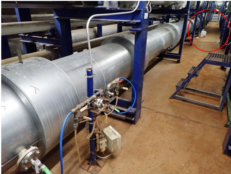
Kuva 24. Mittaukseen käytetty VF60-putki
