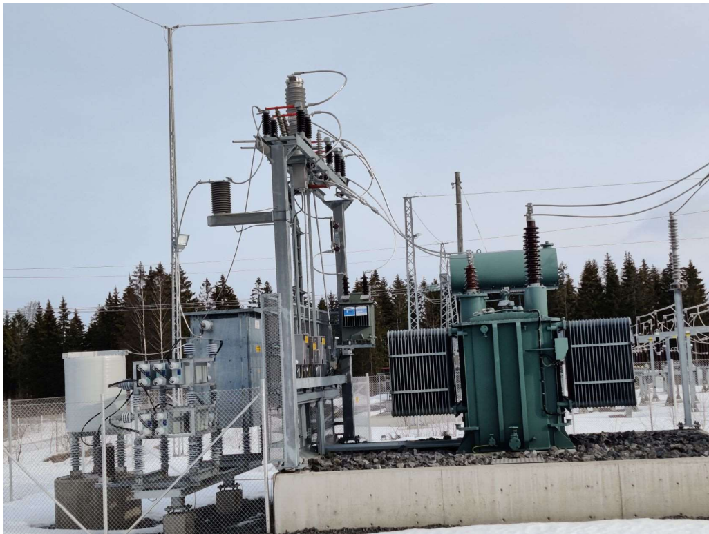
Kuva 2.13. Erään ratasähköaseman kompensointi- ja suodatinlaitteisto päämuuntajan vasemmalla puolella.
