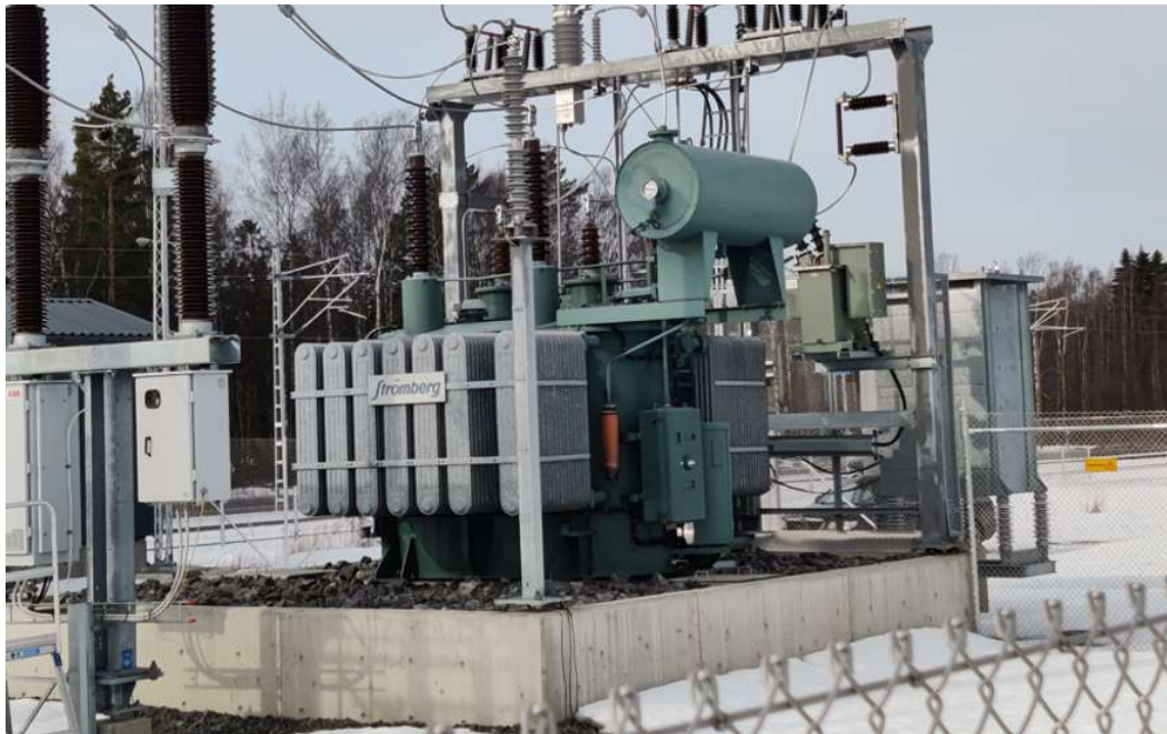
Kuva 1.9. Erään ratasähköaseman päämuuntaja.
