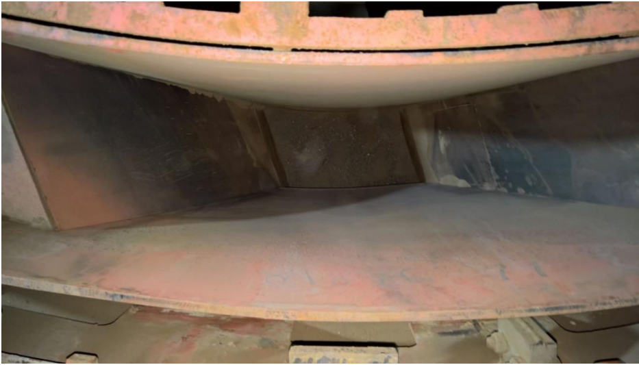
Kuva 7. Toivalan primääri-ilmakanava ylhäältäpäin (Jari Morko, Savon Voima Oyj)
