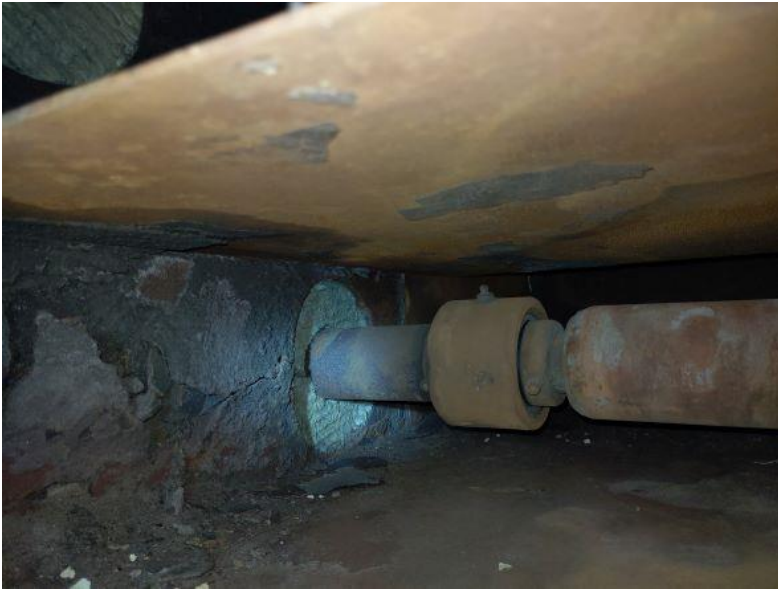
Kuva 6. Voimansiirtoakseli primääri-ilmakanavassa (Jari Morko, Savon Voima Oyj)
