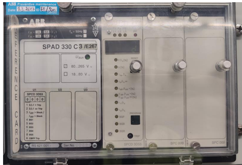
Kuva 4.3 ABB:n SPAD 320 C3 digitaalinen differentiaalirele, joka sisältää vakavoidun differentiaalirelemoduulin SPCD 3D53 ja siinä on vielä kaksi releyksikköä vapaana laajennettavaksi.
