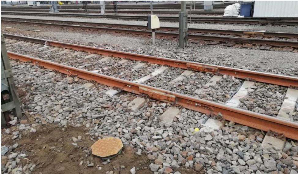
Kuva 7. Kaksikiskoisesti eristetyn raiteen eristysjatkokset ja kytkentäkotelo (Ahola 2021)
