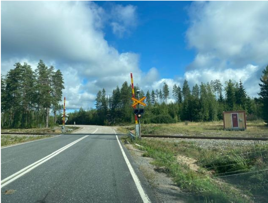
Kuva 6. Ääni -ja valomerkein varustettu varoituslaitos (Ahola 2021)
