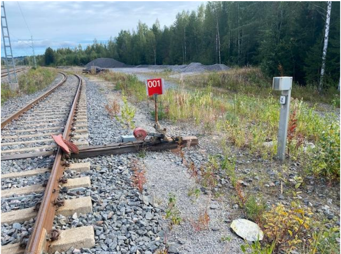
Kuva 9. Avainsalpalaitte, varmistuslukko ja käsikäyttöinen raiteensulku (Ahola 2021)
