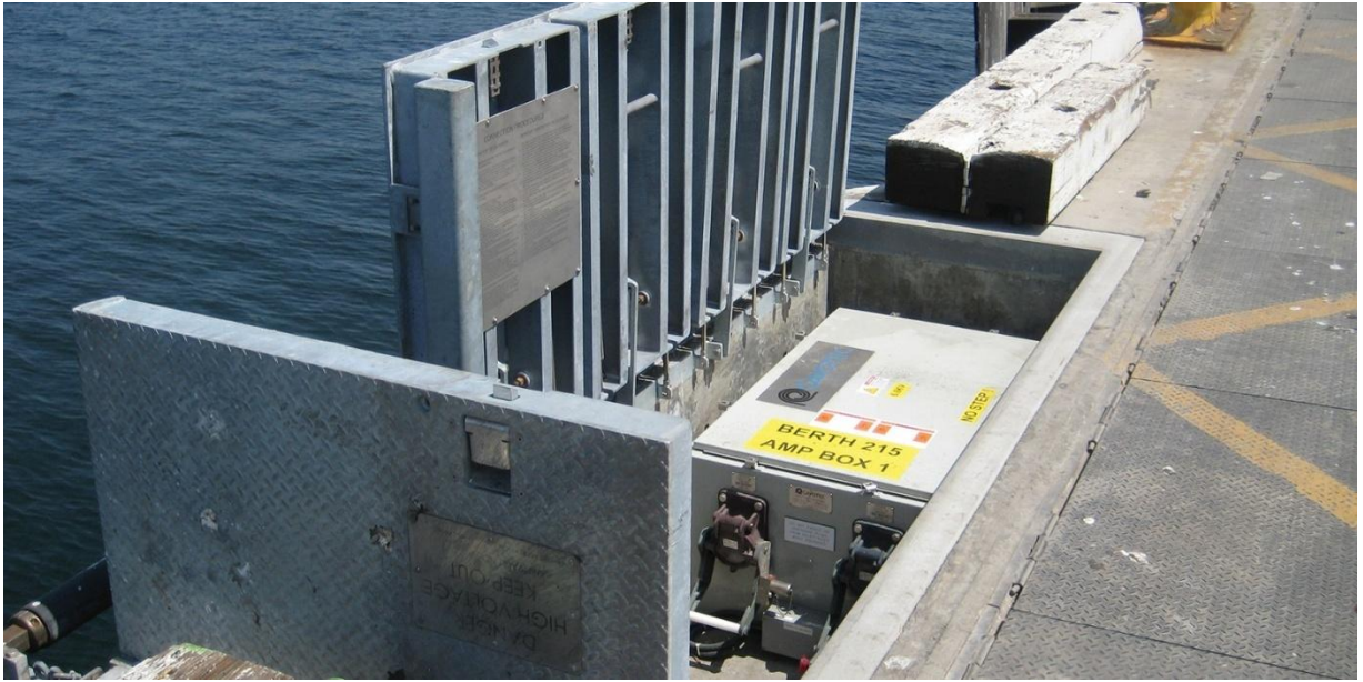
Kuva 3. Laiturirakenteisiin upotettava Cavotec PowerWrap-kaivo, jossa maasähköliittymispiste (Cavotec Group AB, 2025).
