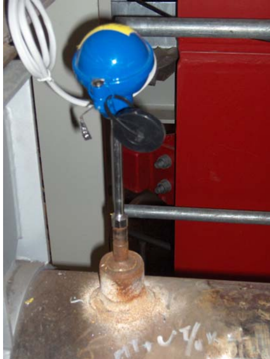
Kuva 4.3 Lämpötila-anturi, johon on asennettu nippusidekiinnityksellä musta eTag.
