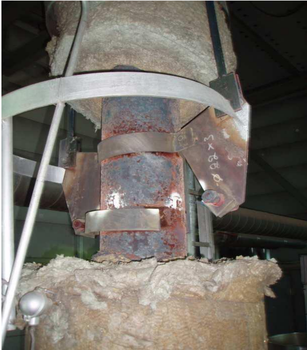
Kuva 15. Lähikuva vaurioituneesta kannakkeesta. (Inspecta Oy. Nikkarila, R. 2009)
