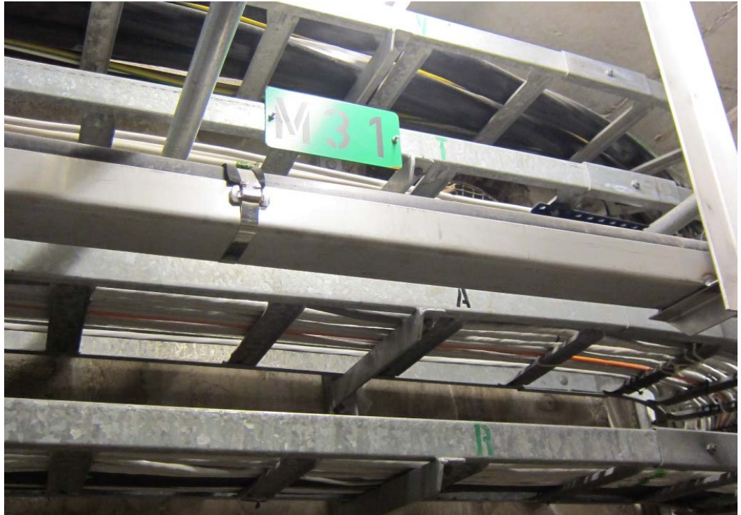
Kuva 16. Kaapelihyllyreittien ja kaapelihyllyjen merkinnät.
