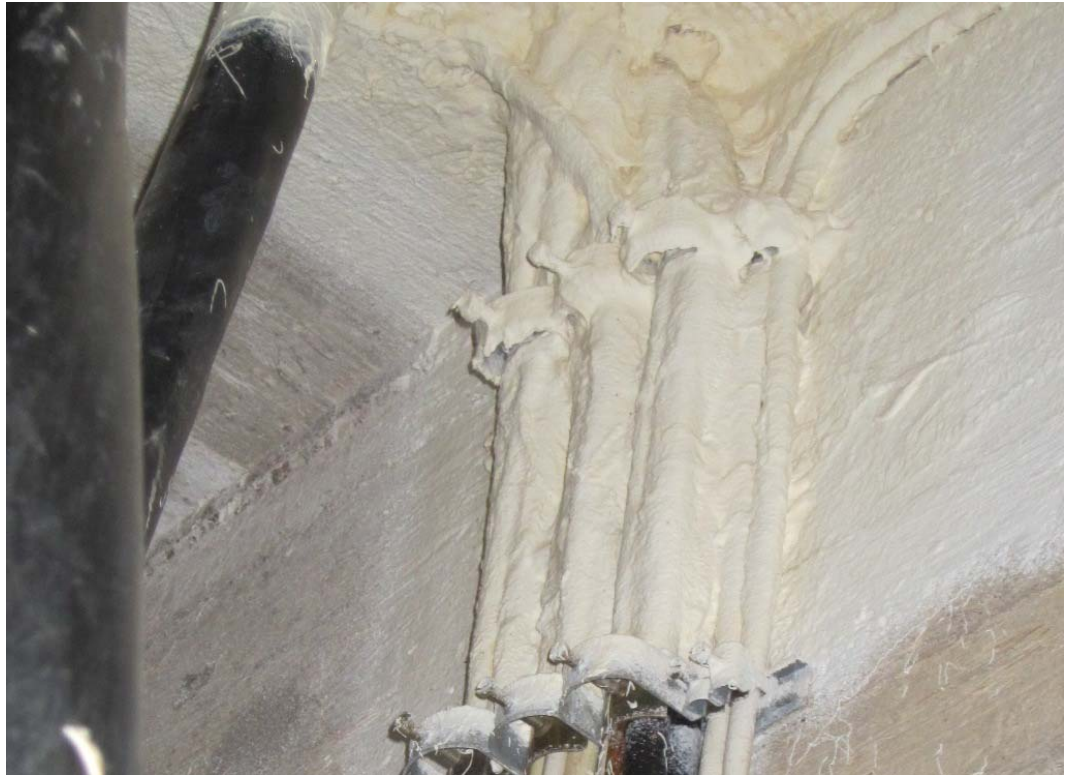
Kuva 20. 2. redundanssin kaapelien laskeutuminen kaapelitunneliin.
