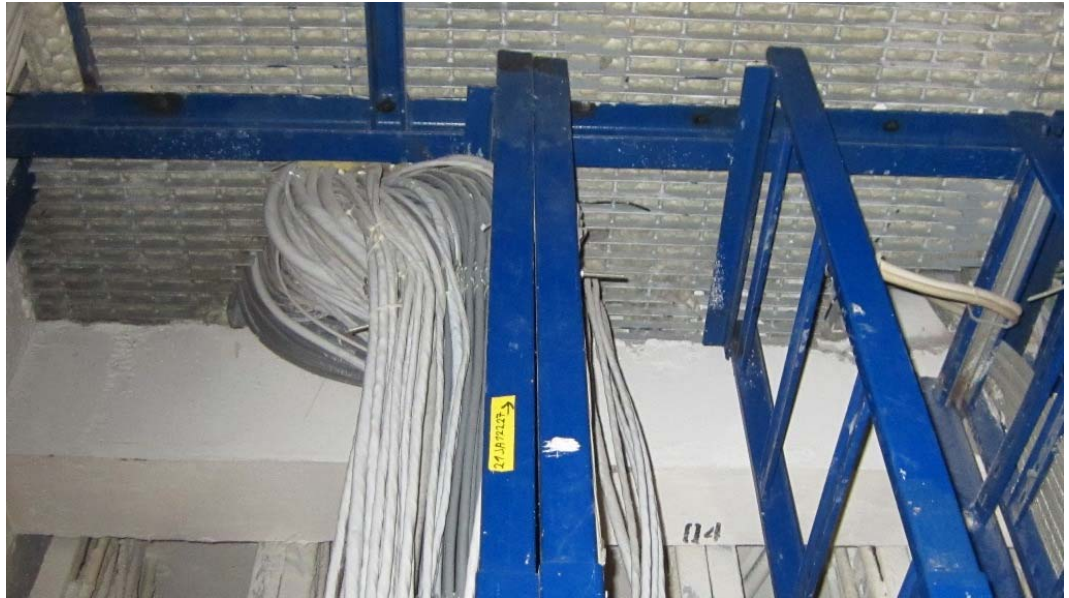
Kuva 19. Läpivienti kaapelinousutilaan 2V0344.
