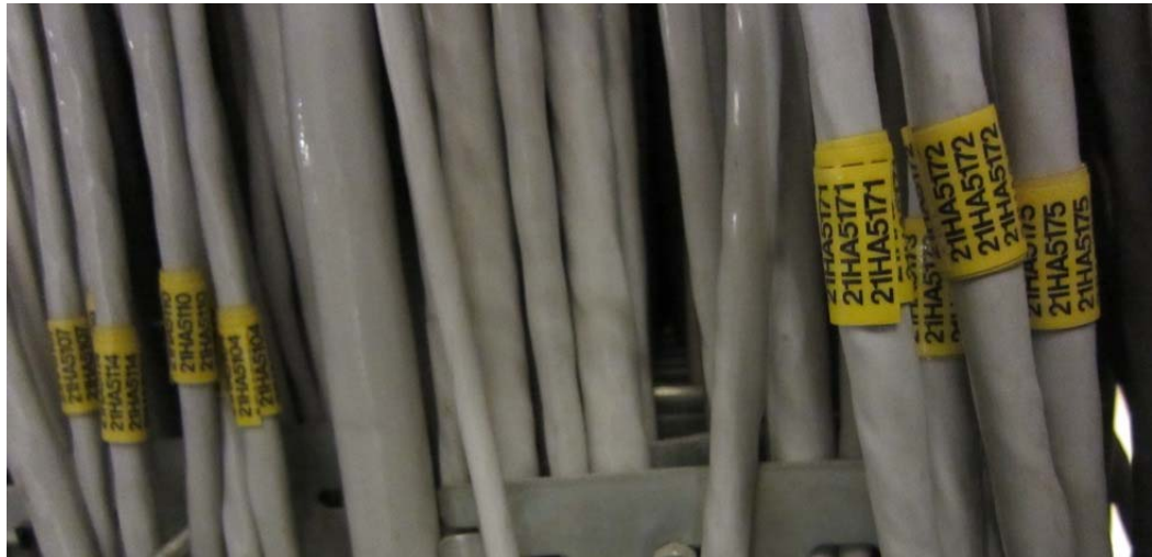
Kuva 18. Automaatiokaapeleiden merkintöjä huoneeseen 2V9031 nousun jälkeen.
