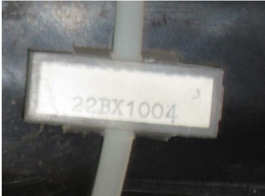
Kuva 15. Muovisella suojakotelolla suojattu kaapelitunnusmerkintä.
