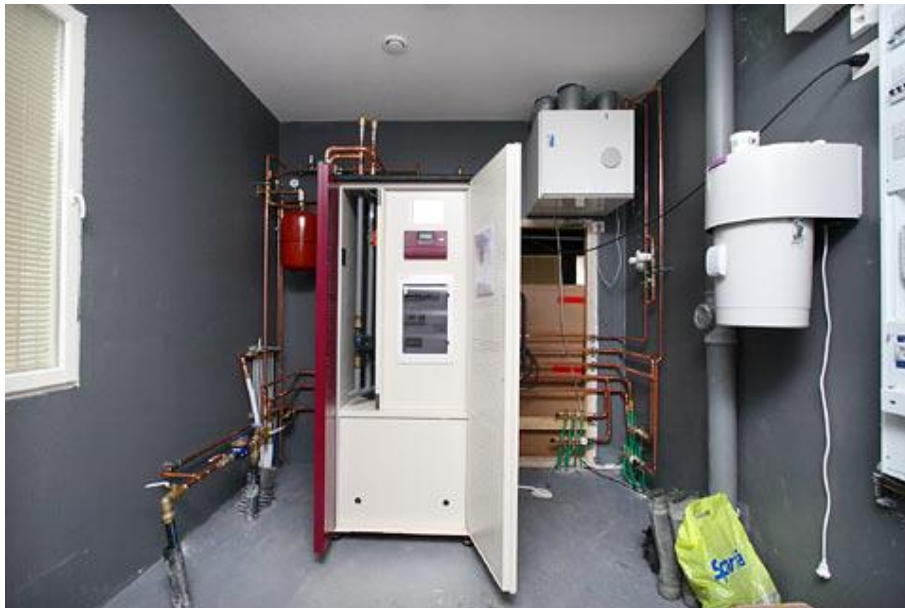
Kuva 1. Kuvassa maalämpöpumppuyksikkö teknisessä tilassa asennettuna. (Rakentaja. 2012a)
