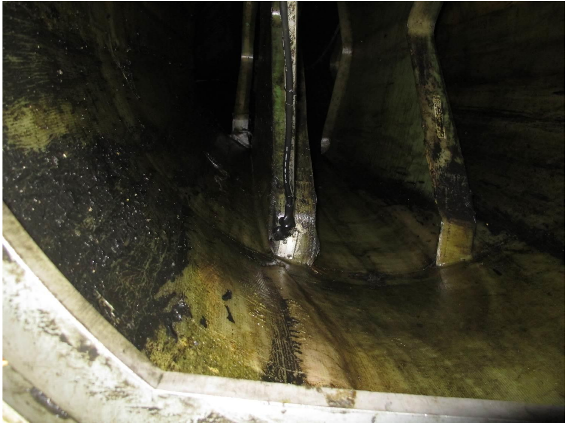
Kuva 7: Kuvassa vaihteiston öljyvudon aiheuttamaa likaantumista lavan sisällä (Bladefence)
