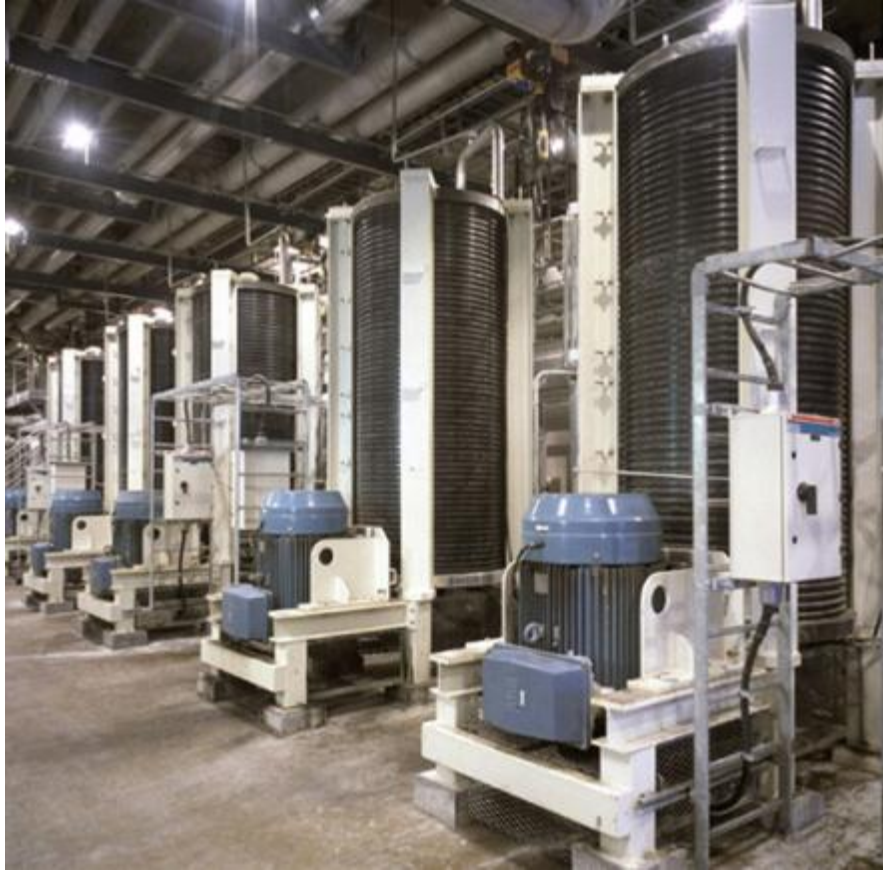
Kuva 26 Kirkniemen paperitehtaalle asennettuja CR1000/60 yksiköitä. [54]
