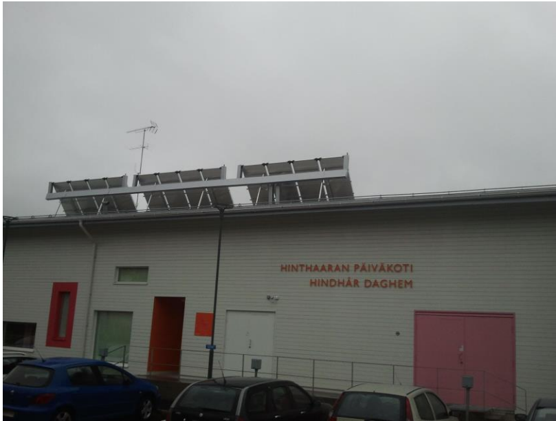
Kuva 13. Aurinkokeräimet veden lämmitykseen.
