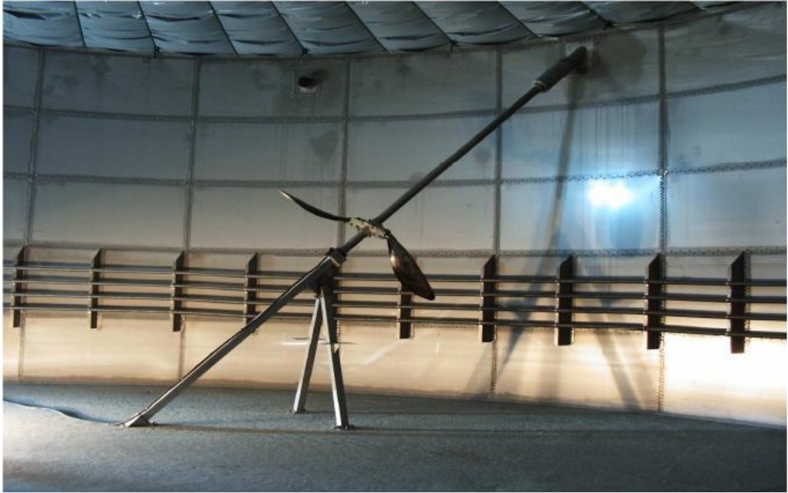
Kuva 10, Doranova Oy. Pitkäakselinen propellisekoitin, jonka moottori on säiliön ulkopuolella.
