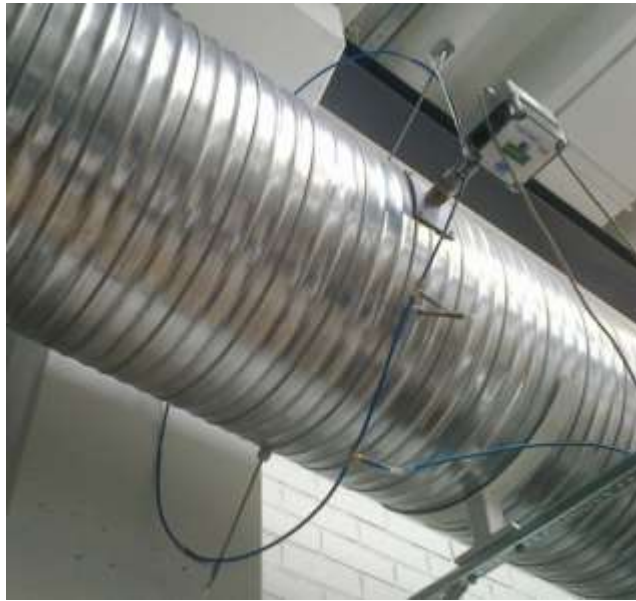
Kuva 8. Massavirtamittari Elridge 9800MPNH ja tulopuolen pitot-putket.
