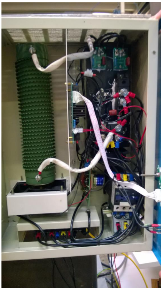
Kuva 4.6 Testatun lataussäätimen sisältämä vastus.
