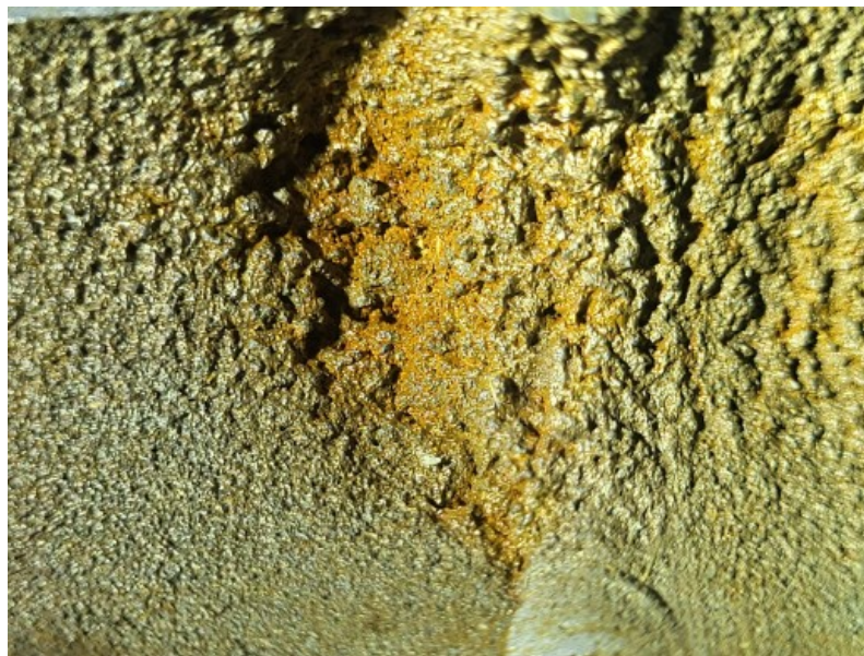
Kuva 17. HSS kertymien aiheuttamaan korroosiota amiinijärjestelmässä H 2 S ja CO 2 sisältävässä amiini-vesiliuos kohteessa (UPM Biopolttoaineet sisäinen dokumentti 2024).
